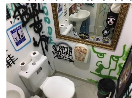
Figura 2. Problema no interior do banheiro
