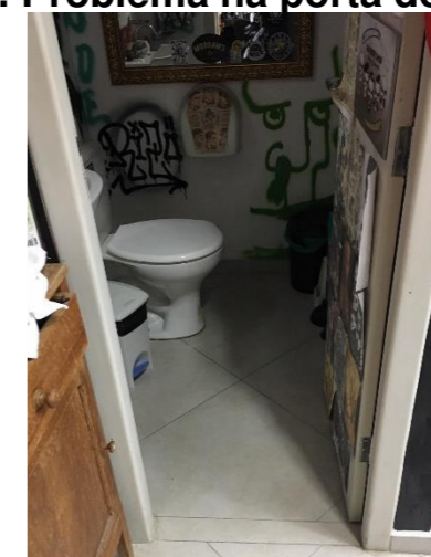
Figura 1. Problema na porta do banheiro.
